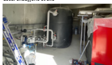
2 chaudières de 170 kW et 1 ballon tampon de 5000 litres
